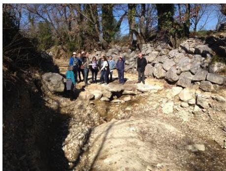
Ouvrage (dégradé) de stabilisation du lit de l'Ourne
